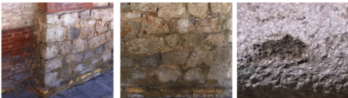
Exemple de modificacions superficials i eliminació o pèrdua de material. Fotografies d'elaboració pròpia
