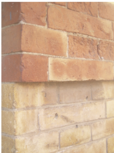
DETALL Fotografia de la fabrica rajola cara vista. Elaboració pròpia.
